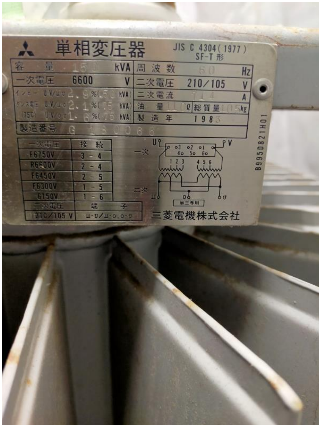
1φ 150kVA 三菱電機
