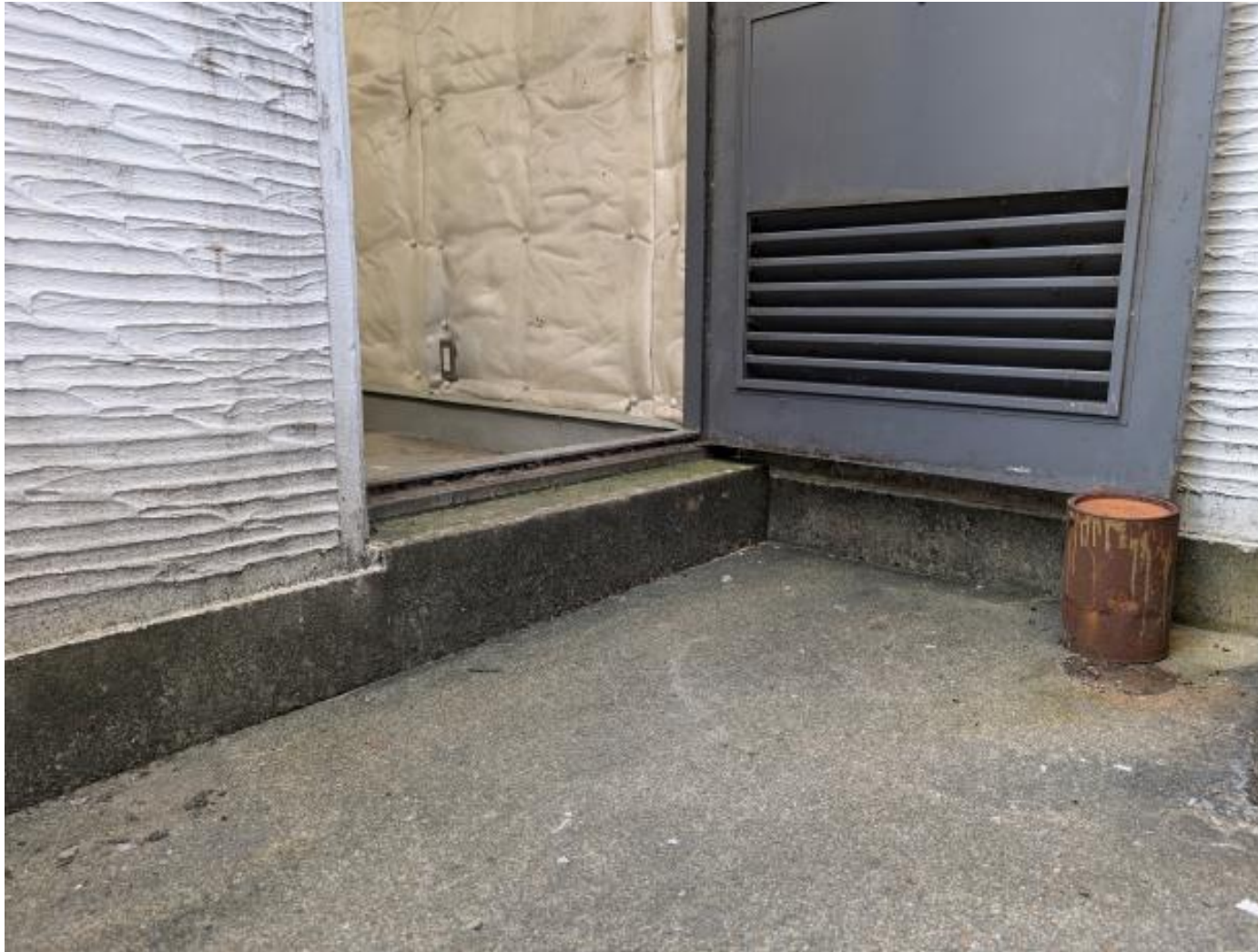
①段差詳細 最大で高さ約23cm
