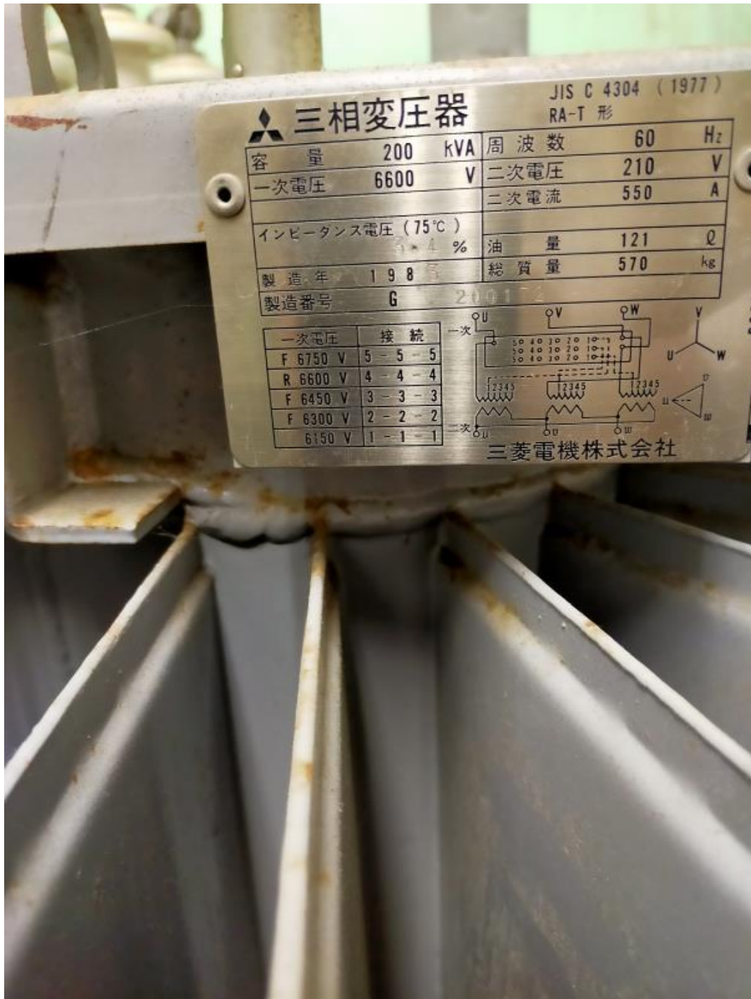
3 φ 200kVA 三菱電機
